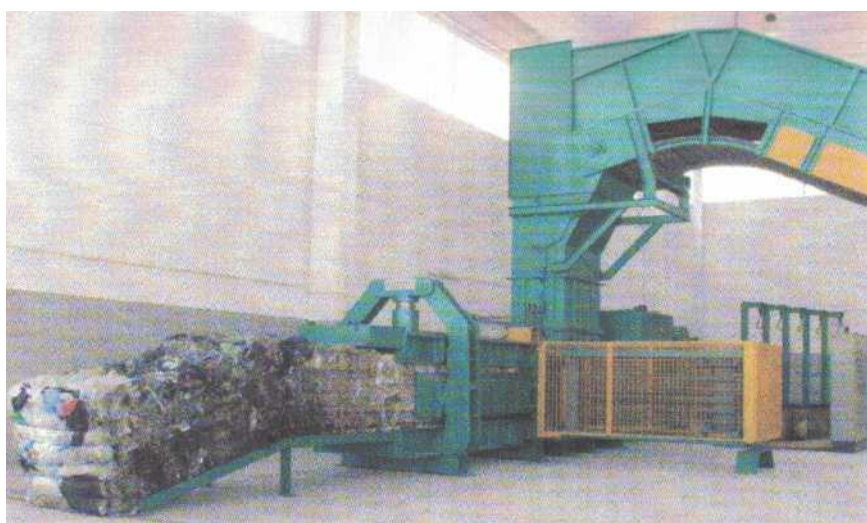
Прессовальная установка на станции сбора и обработки вторсырья
